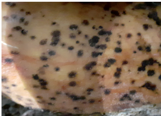
Imagen 17c. Manchas negras producidas por mohos.
