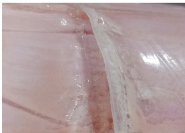
Imagen 35. Rotura de soldadura.
